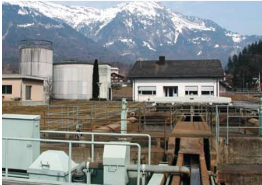
Ein Grossteil des Phosphats aus dem Abwasser, das bis 1975 ungeklärt in den See gelangte, wird heute in den Kläranlagen – wie hier in der ARA Brienz – ausgefällt. Der Nährstoffrückgang schmälert die Produktivität des Sees.
