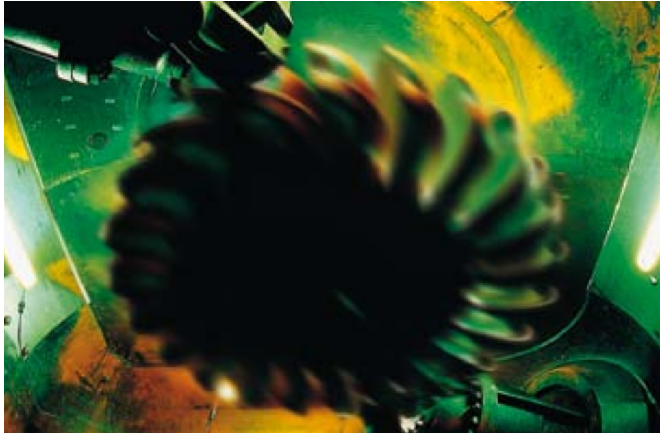
Eine Pelton turbine im Kraftwerk Innertkirchen: Wie aufwändige Untersuchungen im Rahmen der Brienersee-Studie zeigen, hat die Elektrizitätsproduktion keinen wesentlichen Einfluss auf die Grösse der Partikel.
