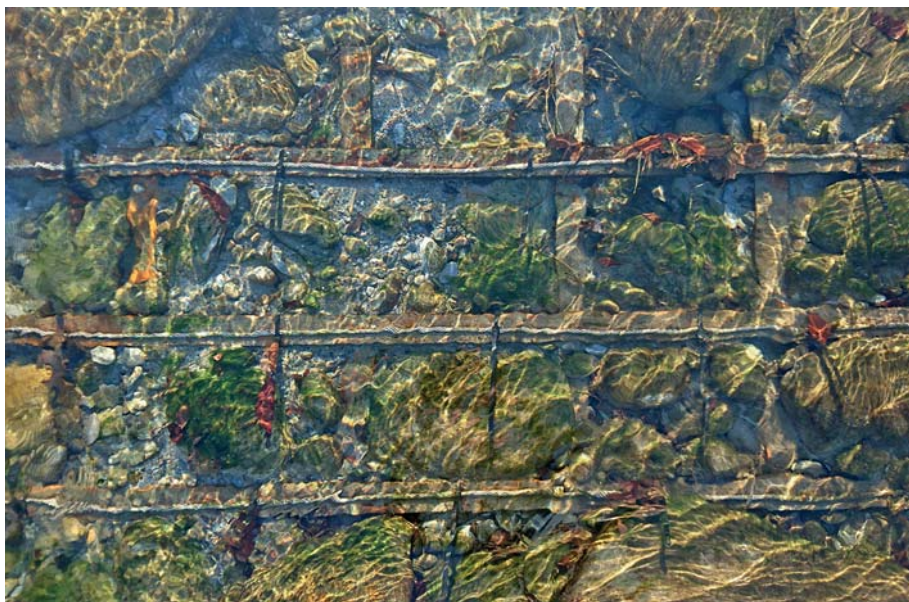
Bild 7. Einbauweise der Elektroden (Bild: Matthias Meyer).
